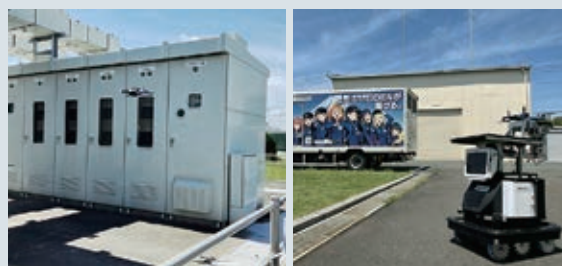
ドローンを用いた特高変電所の保守 ロボットによる設備の地上巡視
