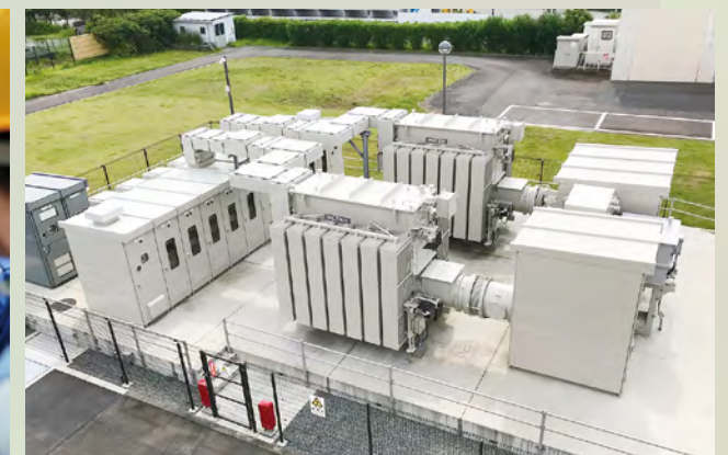
IoTセンサを取り付けたGX特高変電所
