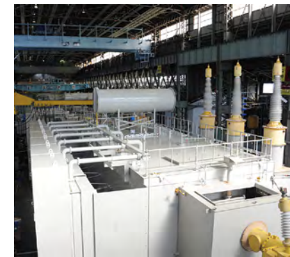
拡張した変圧器工場試験エリア
