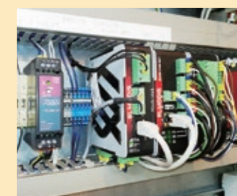
遠隔監視システムの設置例
