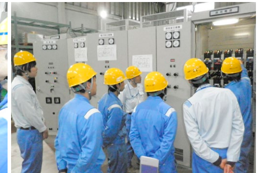
技術研修(高圧受変電設備)
