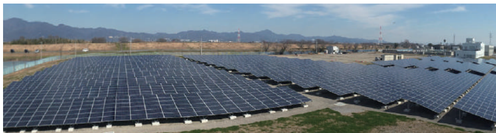
徳島市第十浄水場太陽光発電設備
