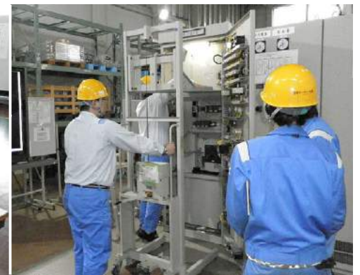
技術研修 (高圧受変電設備)
