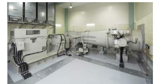
横軸クロスフロー水車と横軸誘導発電機
