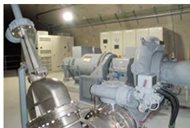
水力発電設備
