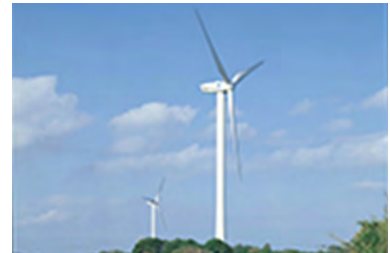
銚子しおさい風力発電所
