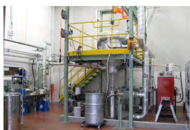
溶解プラントの外観
