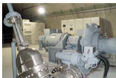
水力発電設備
