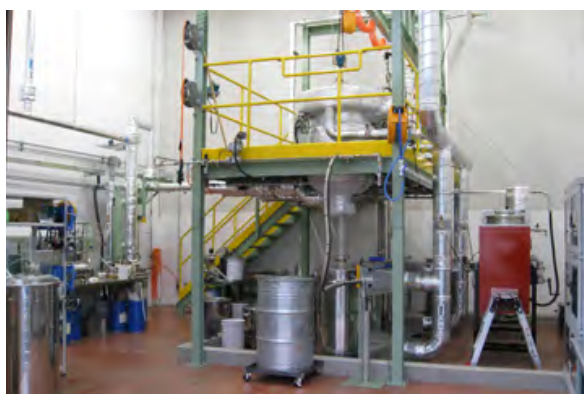
溶解プラントの外観
