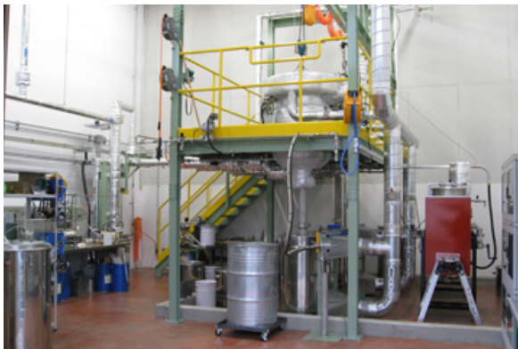
溶解プラントの外観
