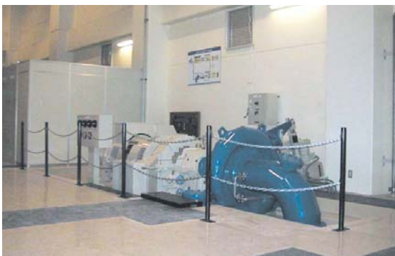
小水力発電システム
