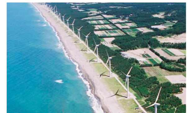
八竜風力発電所
