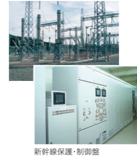
新幹線保護・制御盤
