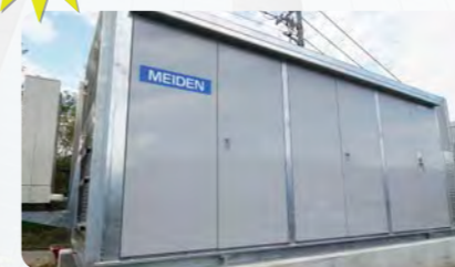
米倉山太陽光発電所に設置されているPCS
