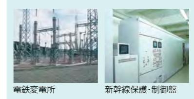
電鉄変電所 新幹線保護・制御盤
