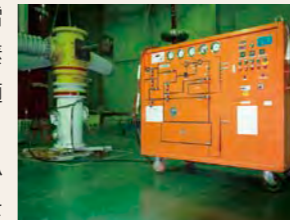
GIS用避雷器の高電圧試験(右:SF 6 ガス回収装置)
