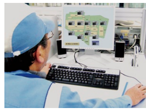
電力監視システムでの監視
