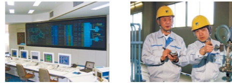
監視制御システム
