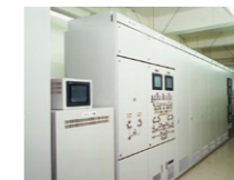
新幹線保護・制御盤
