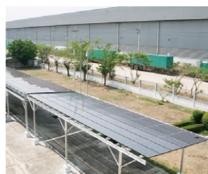
太陽光パネル
