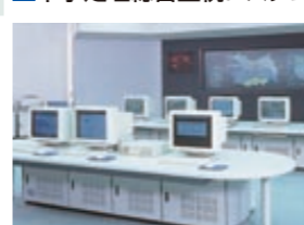
■下水処理総合監視システム
