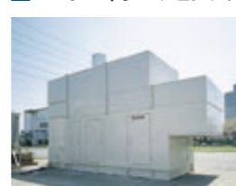
■コージェネレーションシステム
