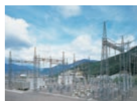
■変電プラント
