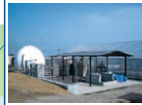
■バイオマス発電システム
