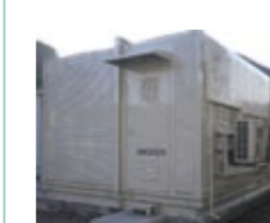
キャパシタ外観(屋外設置)
