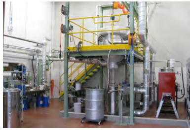
溶解プラントの外観
