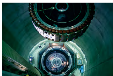
水力発電設備
